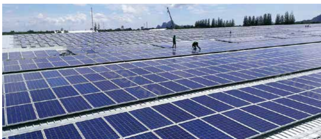
泰国 9MW 9MW - Lamchabang, Thailand
