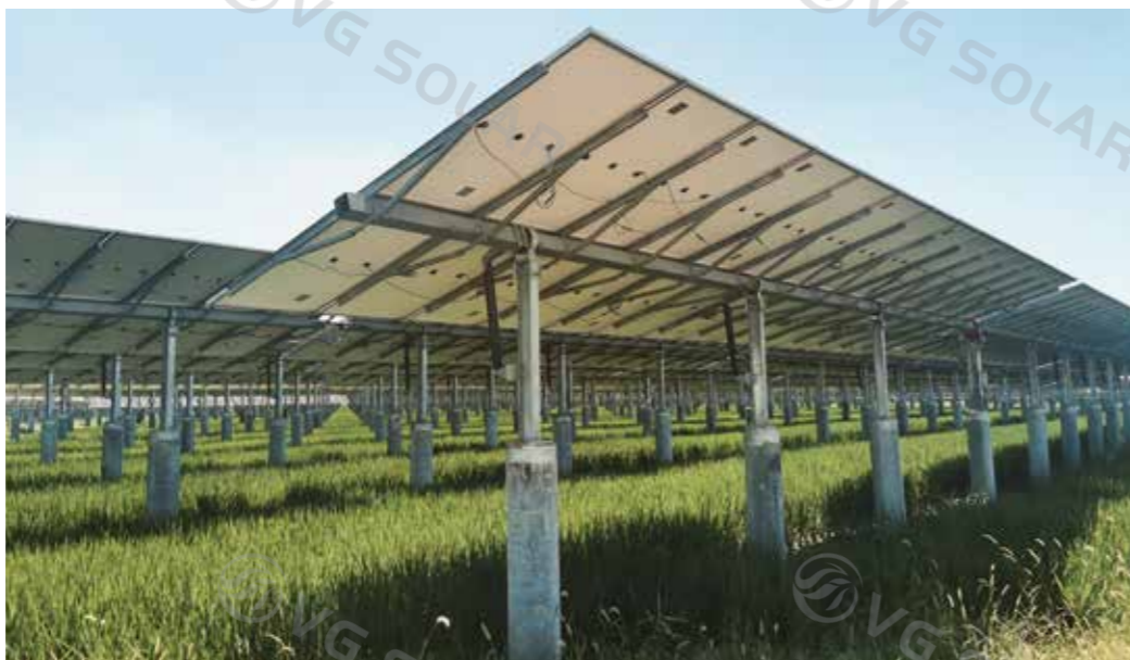
浙江温州150MW跟踪项目 150 MW - Zhejiang,China
